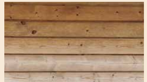
Veggen til en brundyppt hytte, som har vært utendørs i fire år uten ytterligere etterbehandling. Delen som er utsatt for sol er kraftig falmet.
